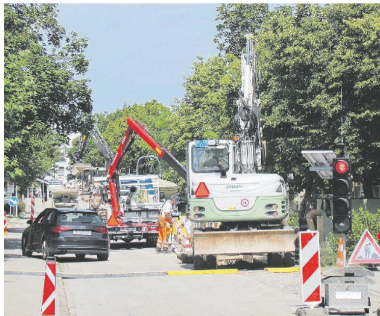
Die Baustelle Ackerstrasse stellt für die Gemeinde eine Herausforderung dar. BILD TSP
