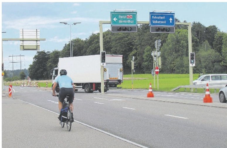
In diesem Abschnitt über der Autobahn wird Ende Oktober der Belag saniert. BILD TSP
