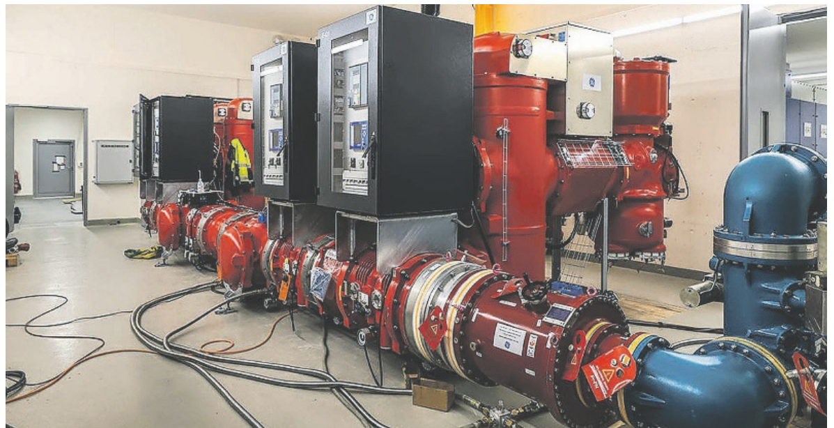
Letzte Phase der Montage der 110-kV-Schaltanlage (rechts der temporäre Anschluss für die Hochspannungsprüfung).
