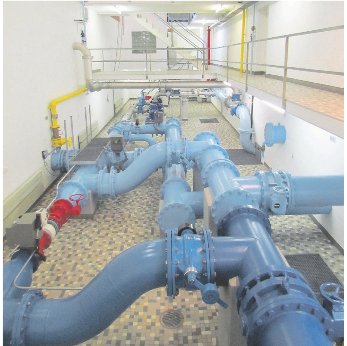
Das Reservoir auf dem Homberg wurde 1975 erbaut und ist der grösste Wasserspeicher in Volketswil.
